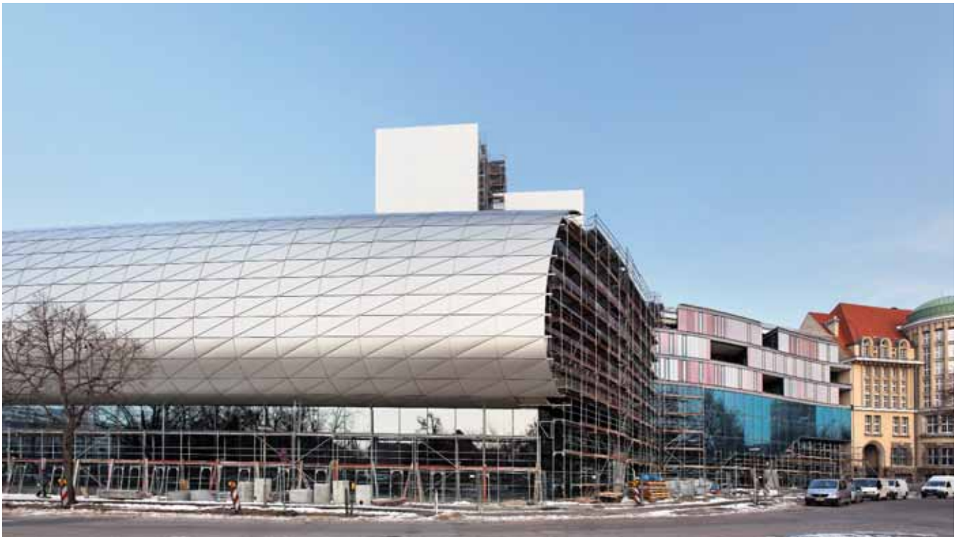
4. Erweiterungsbau der Deutschen Nationalbibliothek in Leipzig © Staatsbetrieb Sächsisches Immobilien- und Baumanagement, Niederlassung Leipzig I, Foto: Klaus-D. Sonntag
