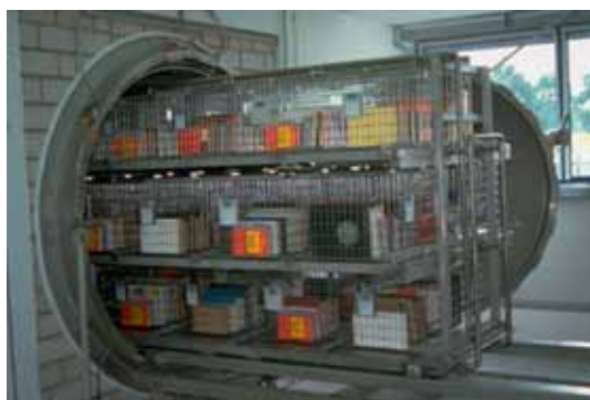
Massenentsäuerungsanlage, ZFB Zentrum für Bucherhaltung GmbH Leipzig, um 2000
